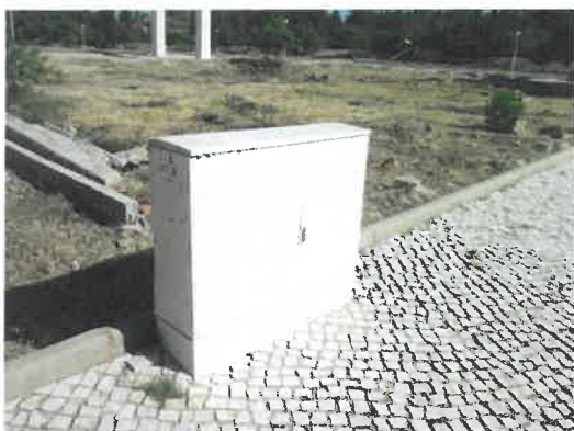
Infraestruturas – rede de eletricidade
