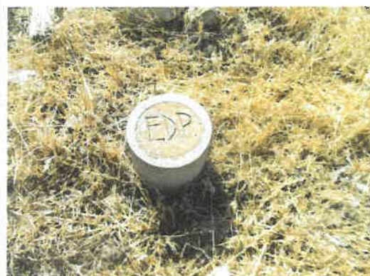
Lote 4 – Infraestrutura eletricidade
